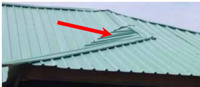
Verkeerd geplaatste dakplaten
